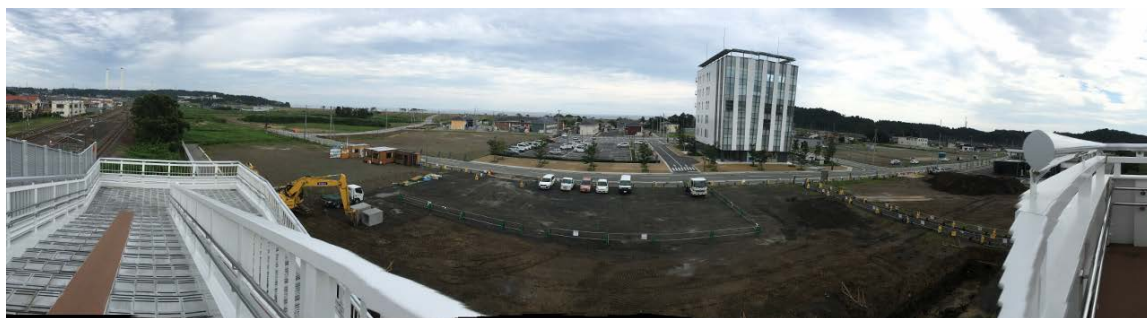
図9. 広野駅前 更地にされて道路や建物（広野みらいオフィス 写真中央の建物）が建築中 遠方には太平洋が望める（2017年3月 パノラマ撮影）
