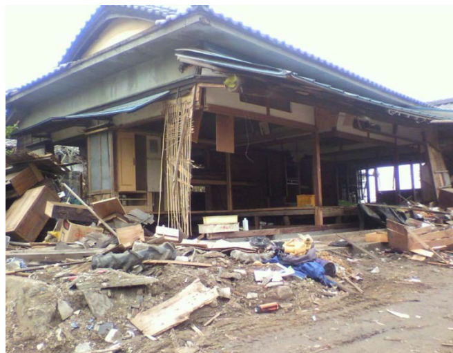
図8. 津波被害を受けた家屋（広野町内）（2011年6月撮影）
